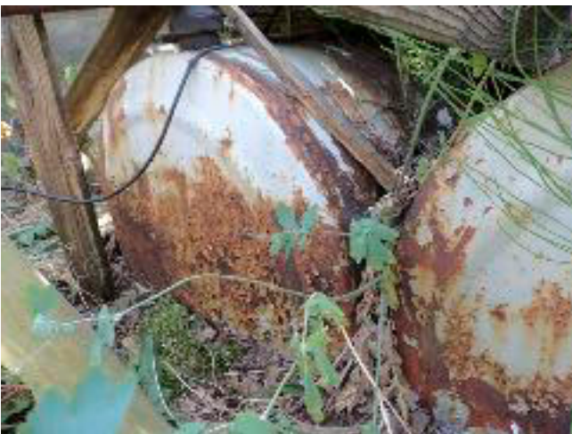
Foto 3c: Detail HEL-Tanks in mit Glasfaser und Styropor verfüllter Betonwanne
