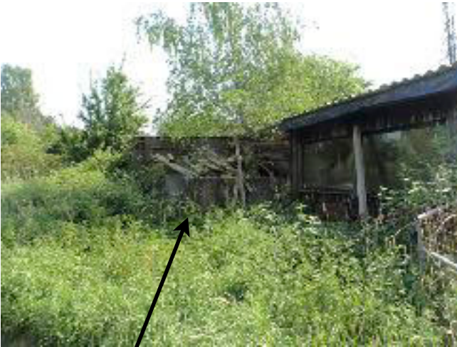
Foto 3a: HEL-Tanks in offener betonierter Wanne, einfaches Dach inzwischen eingestürzt
